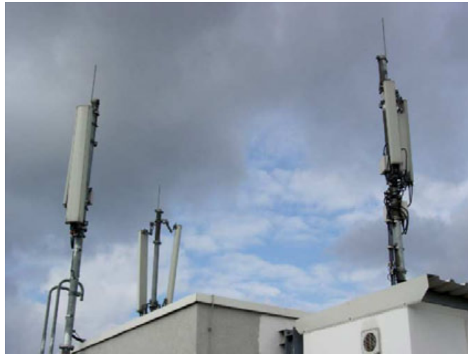
UMTS-Basisstation der Deutschen Telekom in Hannover. Foto: Hurcks
